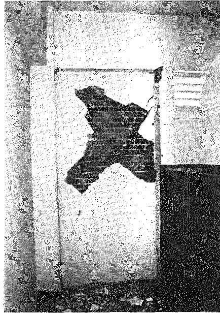
Figura 3.56 Daño moderado en un muro de relleno de mampostería confinada del cuarto de aire acondicionado
